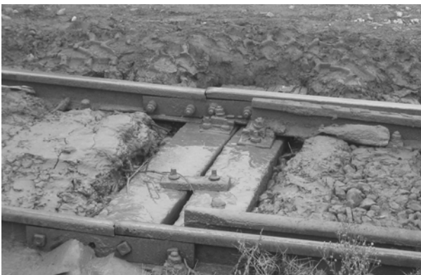
Εικόνα 1.3: Ακατάλληλη επιδομή, ράγες με διάκενα, αμφιδέτες...
