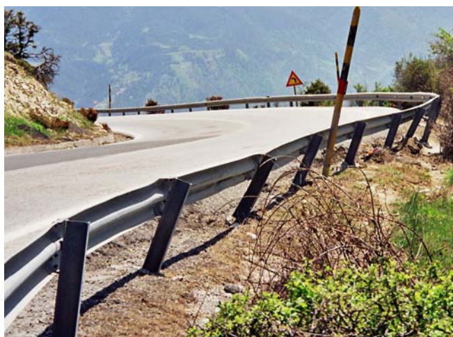
Km 20: Άλλη μία παρόμοια περίπτωση. Πιθανότερη εξήγηση για αυτήν την κατάσταση αποτελεί η έντονη πλευρική καταπόνηση από τους συχνούς αποχιονισμούς, σε συνδυασμό με ελλιπές βάθος έμπτυξης, ανεπαρκή πλευρική επικάλυψη ορθοστατών στη στέψη απότομων πρανών, κακό έδαφος.
