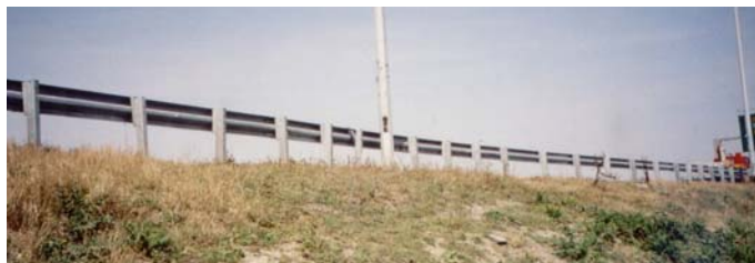
Εικόνα 11.6: Πύκνωση ορθοστατών μεταλλικών στηθαίων στις θέσεις των στύλων ηλεκτροφωτισμού.
