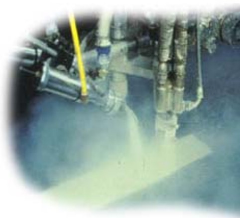
Εικόνα 2.11: Εφαρμογή θερμοπλαστικής διαγράμμισης με ψεκασμό. Διακρίνεται και η διασπορά των γυάλινων σφαιριδίων.
