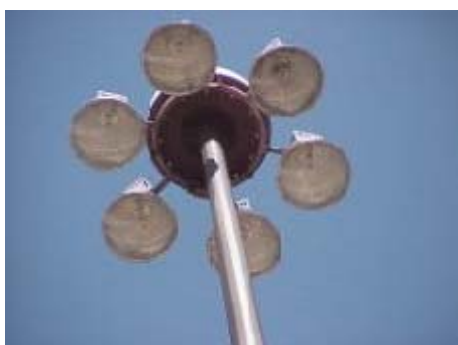
Εικόνα 7.4: Φωτιστικά σώματα υψηλού ιστού.
