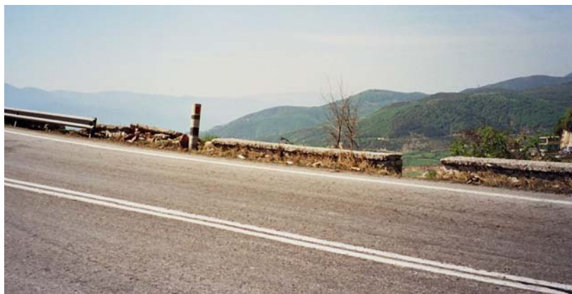
Km 29: Λίθινα στηθαία βρισκόμενα σε κακή έως οικτρή κατάσταση, τα οποία, όμως, θεωρούνται επαρκή ώστε να διακόπτονται τα αντίστοιχα μεταλλικά.
