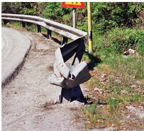
Km 19: Άλλο ένα μεγάλο πρόβλημα των μεταλλικών στηθαίων στην ορεινή διάβαση Καστανιάς είναι η συστηματική αποφυγή της κατάλληλης διαμόρφωσης των αιχμών. Η πρόσπτωση ενός οχήματος αξονικά επάνω στην αιχμή μπορεί να έχει πολύ σοβαρές συνέπειες.
