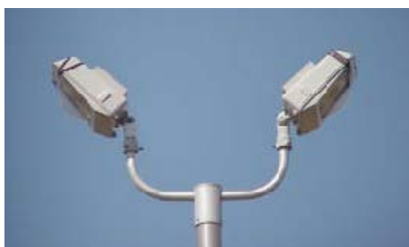
Εικόνα 7.3: Φωτιστικό σώμα κατακόρυφης διάταξης.
