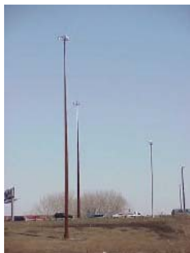
Εικόνα 7.12: Φωτισμός επί υψηλών ιστών.
