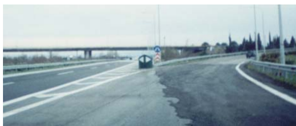
Εικόνα 11.7: Απουσία διάταξης απορρόφησης ενέργειας στην αιχμή της εξόδου.
