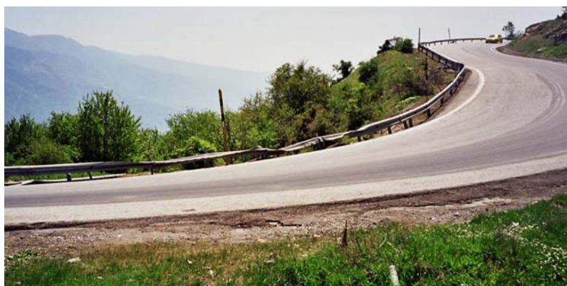
Km 20: Άλλη μία περίπτωση καταπονημένου στηθαίου, αυτή τη φορά στο εσωτερικό της στροφής. Οι έντονες καμπυλότητες, κατά μήκος κλίσεις και επικλίσεις μπορεί να καταστήσουν το χεμώνα χρήσιμα τα στηθαία και στις εσωτερικές οριογραμμές των στροφών.
