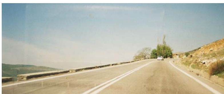
Km 31: Μετά από σειρά ασφαλτοστρώσεων, τα λίθινα αυτά στηθαία δεν εξέχουν παραπάνω από 10~20 cm, μη όντας σε καμία περίπτωση σε θέση να συγκρατήσουν την έξοδο οχημάτων, αφήνοντας απροστάτευτο ένα μεγάλο μήκος.
