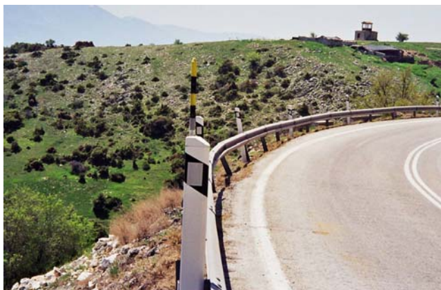
Km 26: Είναι άγνωστος ο βαθμός προστασίας που μπορεί να παρέχουν στηθαία με ήδη ξηλωμένους ορθοστάτες. Το εν λόγω στηθαίο βρίσκεται κυριολεκτικά στο χείλος του γκρεμού.
